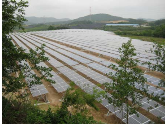
Jeongeup 1.6 MW PV Array (HHI modules)
